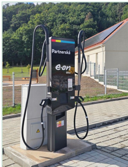
DC 50 kW · E.ON (veřejná)
