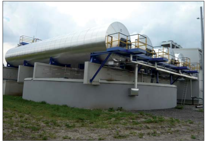
Foto 2: Pohled na válcové ocelové fermentory (nahore) a betonový fermentor (dole) – BPS Zwentendorf (Rakousko) [1,7] – foto autor.
