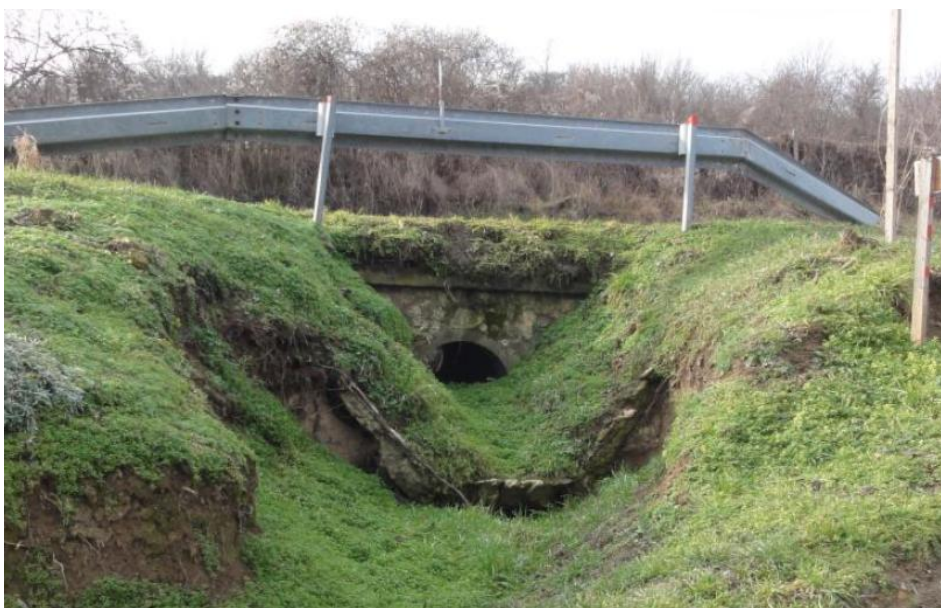
Obr. 6 - Uzávěrný profil Bodu 4 - zanesené potrubí propustku DN 800 - stav před 07/2016 (zdroj [30])
