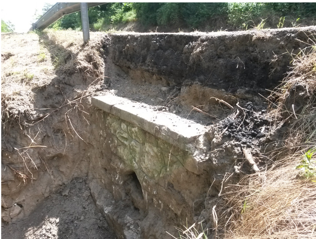
Foto 12: Propustek č. 3 byl dne 7. Července 2016 čištěn. Na fotografii je dobře patrná úroveň kolmatace hlínami původní římsa propustku. Na něm je pak několik vrstev asfaltu. Foto: P. Kycl 07.07.2016.
