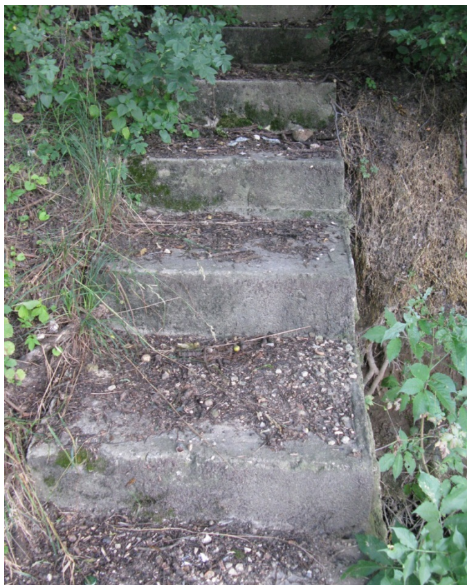
Obr. 24. Pohled na stávající betonový opěrný prvek (žebro) při patě svahu – sesuv č. 1f 1 . Foto: R. Novotný, 7.7.2016.
