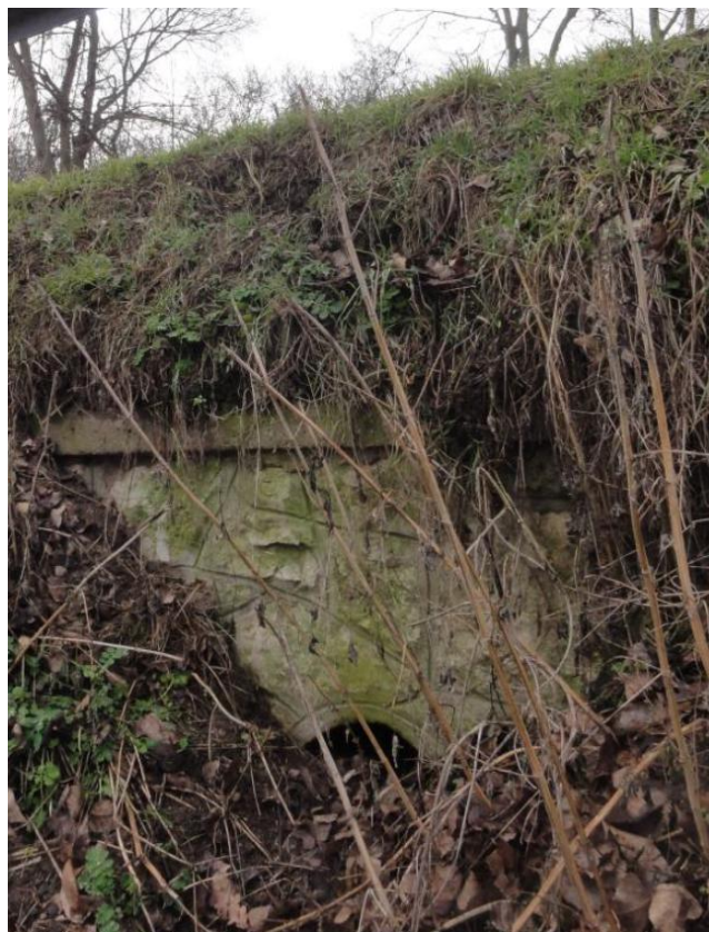
Obr. 4 - Uzávěrný profil Bodu 3 - zanesené potrubí DN 600 - stav před 07/2016 (zdroj [30])
