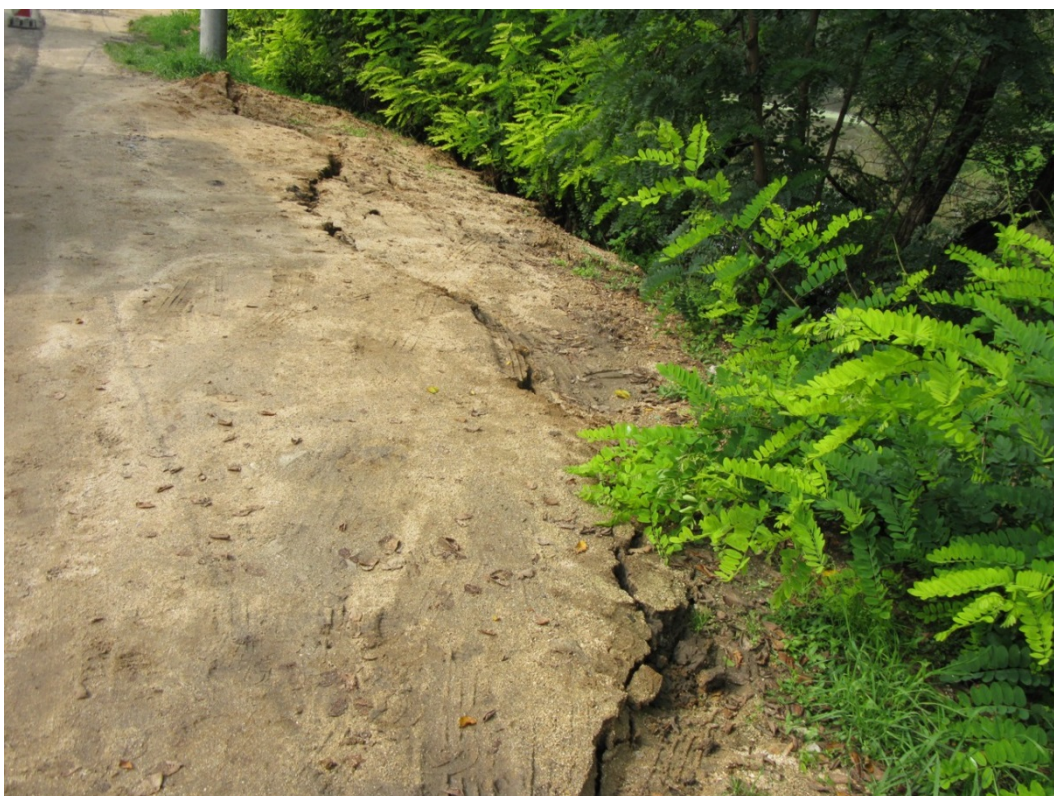
Foto 8: Trhliny na čele sesuvu č. 1f 1 v Dolních Věstonicích. Foto: R. Novotný, 15.09.2014.
