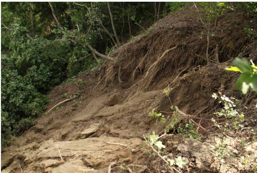
Foto 6: Pohled na odlučnou oblast aktivního proudového sesuvu č. 1b 1 s výraznou vodní erozí a soliflukcí. Foto: R. Novotný, 22.09.2014.
