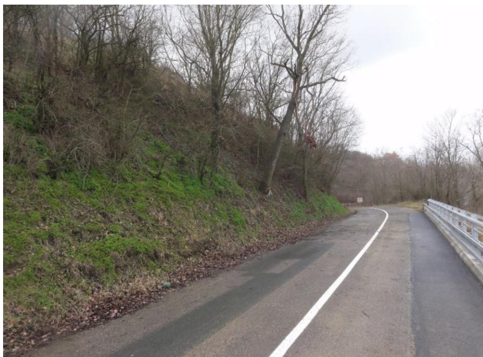
Obr. 8 - Absentující příkop u krajské komunikace (zdroj [30])
