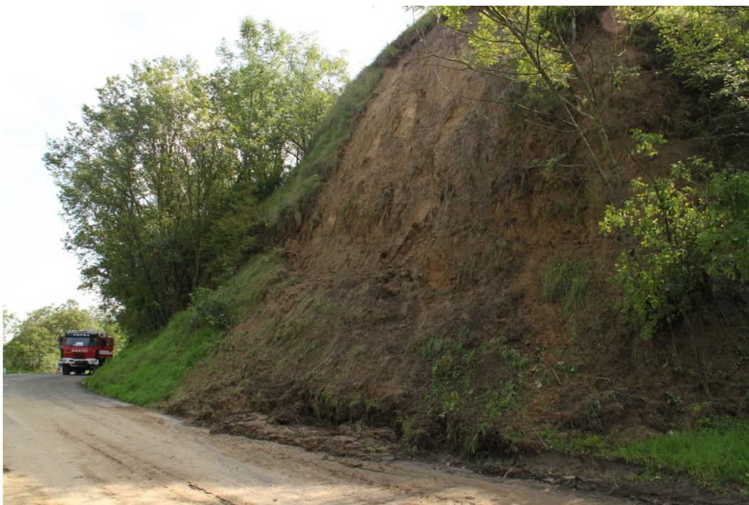
Foto 3: Odlučná hrana a akumulční část aktivního zvodněného zátrhu nad sesuvem č. 1a. Foto: R. Novotný, 15.09.2014.
