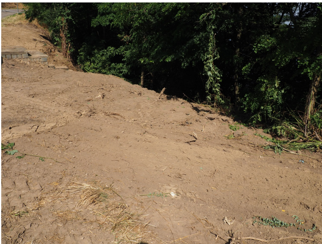
Foto 17: Přesypávání přes hranu svahu je aktivní nejen na objektu SO 02.11, ale také na objektu SO 03, kde byl materiál vytěžený ze zanesených propustků a odvodňovacích příkopů bez hutnění přesypáván přes korunu svahu. Takový materiál je pak velmi náchylný k dalším pohybům. Foto: P. Kycl 07.07.2016.
