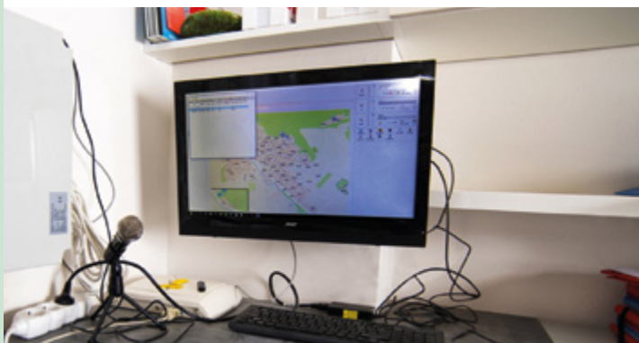
Systém včasného varování a informování obyvatel obce Trnová – řídicí pracoviště varovného systému. Foto: SFŽP ČR
