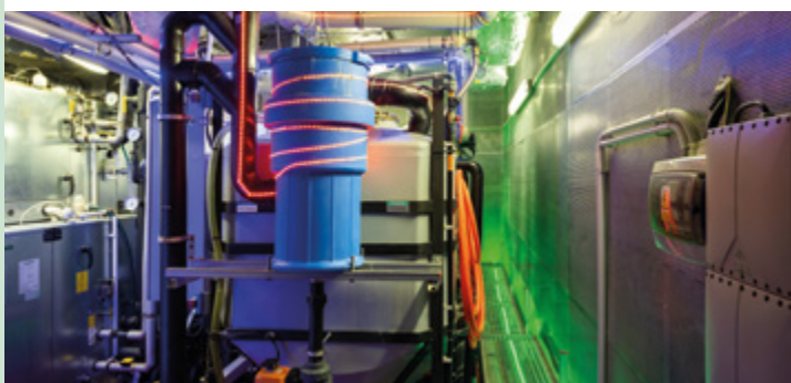
Mosaic House Design Hotel – systém čištění šedé vody a rekuperace tepla z odpadní vody. Foto: Nadace Partnerství, Vojta Herout
