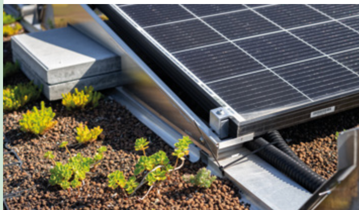
Biosolární střecha na škole Českobrodská v Praze 9 – příklad synergie adaptačních a mitigačních opatření. Foto: Nadace Partnerství, Vojta Herout
