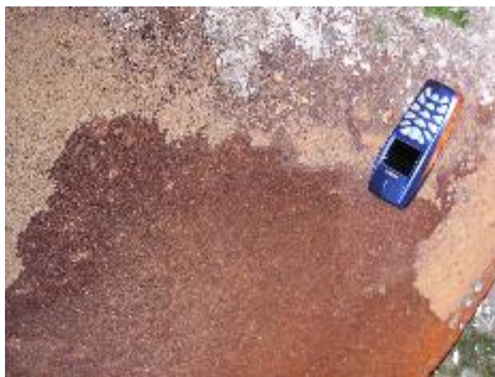
Obr. 4.17: Snímek korozi napadeného vodovodního přivaděče
